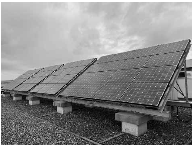
県有施設の屋上に設置された太陽光発電設備
