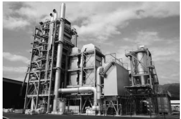
木質バイオマス発電施設（大野市）
