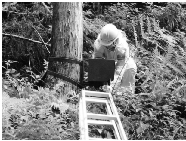
監視カメラの設置
