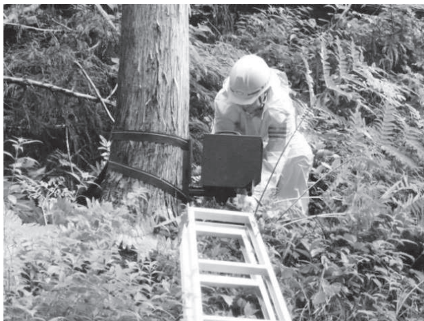
監視カメラの設置
