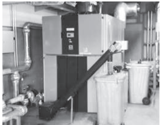
温泉施設に設置された 木質チップボイラー（あわら市）
