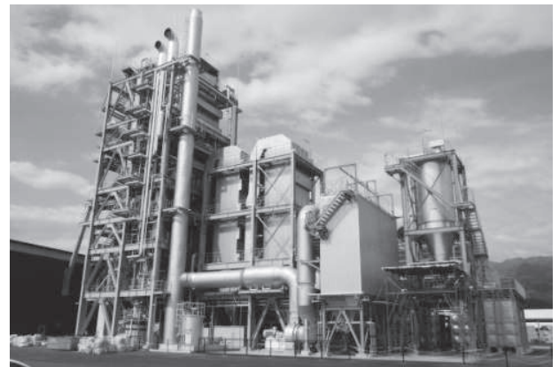
木質バイオマス発電施設（大野市）
