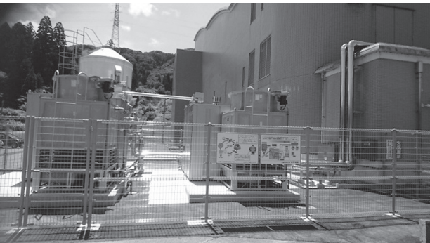
(上志比文化会館 木質バイオマスボイラー)
