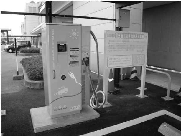
フェアモール福井(福井市)に設置した急速充電器
