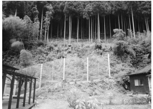
崩壊土砂防止柵（清水地区 おおい町川上）
