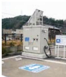
⑥ EV充電設備
