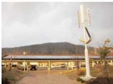
⑤ ハイブリッド型LED照明・太陽光発電設備
