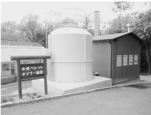
木質ペレットボイラー施設外観
