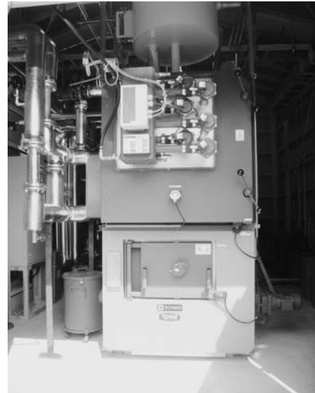
木質ペレットボイラー
