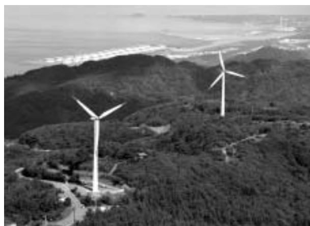
国見岳風力発電所
