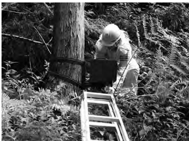
監視カメラの設置
