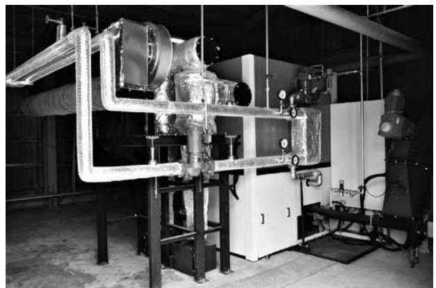
温泉施設に設置された 木質チップボイラー（あわら市）
