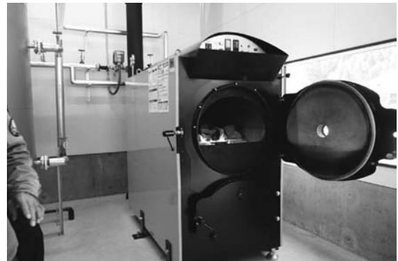
福井市伊自良温泉に設置された薪ボイラー
