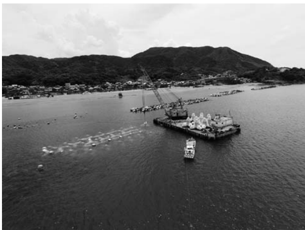
砂の移動を防止するための構造物の整備状況 (福井市浜住海岸)
