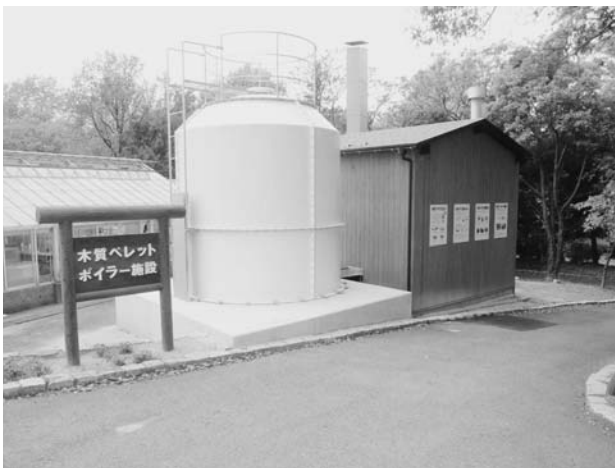
木質ペレットボイラー施設外観
