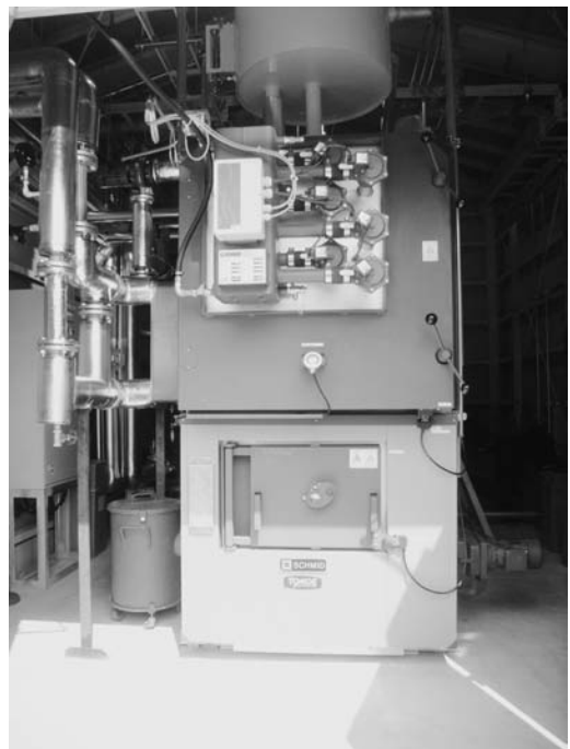
木質ペレットボイラー
