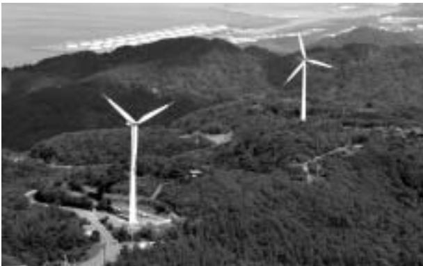
国見岳風力発電所
