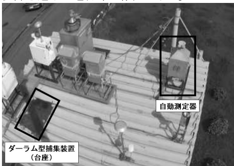
図1 装置設置場所（福井局屋上）
